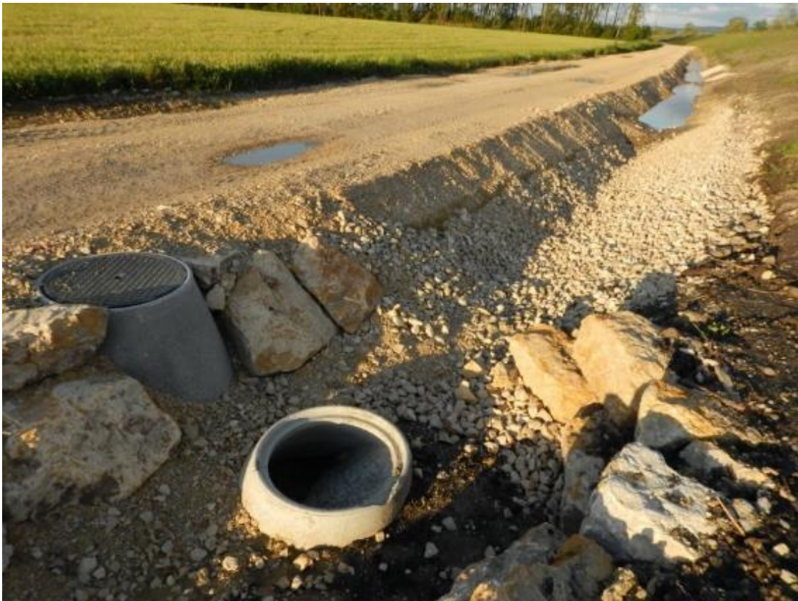
Fig. 5 : Fossé de drainage superficiel avec un puits de déversement ménageant les amphibiens le long de la digue du canal de Hagneck. © Silvia Zumbach
