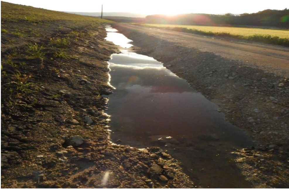
Fig. 3 : Fossé subdivisé par tronçons le long du canal de Hagneck, canton de Berne. En raison du fort apport de sédiments, les cuvettes doivent être régulièrement reconstituées lors des travaux d'entretien. © Silvia Zumbach
