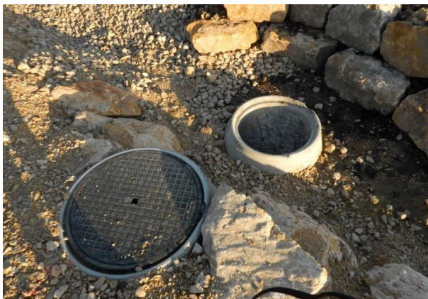
Fig. 8 : Système à deux puits. Le puits d'entrée n'est pas installé au niveau du sol, mais surélevé, afin que l'eau reste dans la tranchée (à droite sur la photo, après la construction, encore sans eau). © Silvia Zumbach
