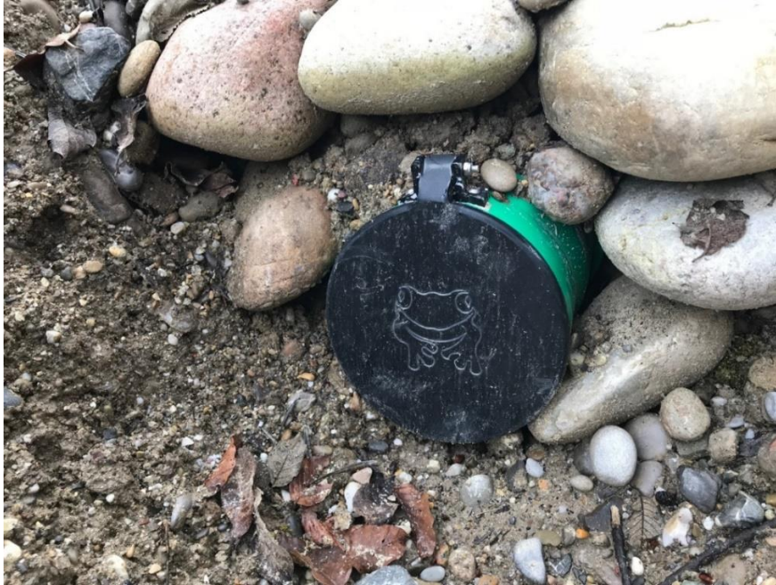
Abb. 10: Entwässerungsleitung mit einer Amphibienschutzklappe durch einen neuen BLS-Damm in Ramsei. © Lukas Kohli, Hintermann+Weber AG
